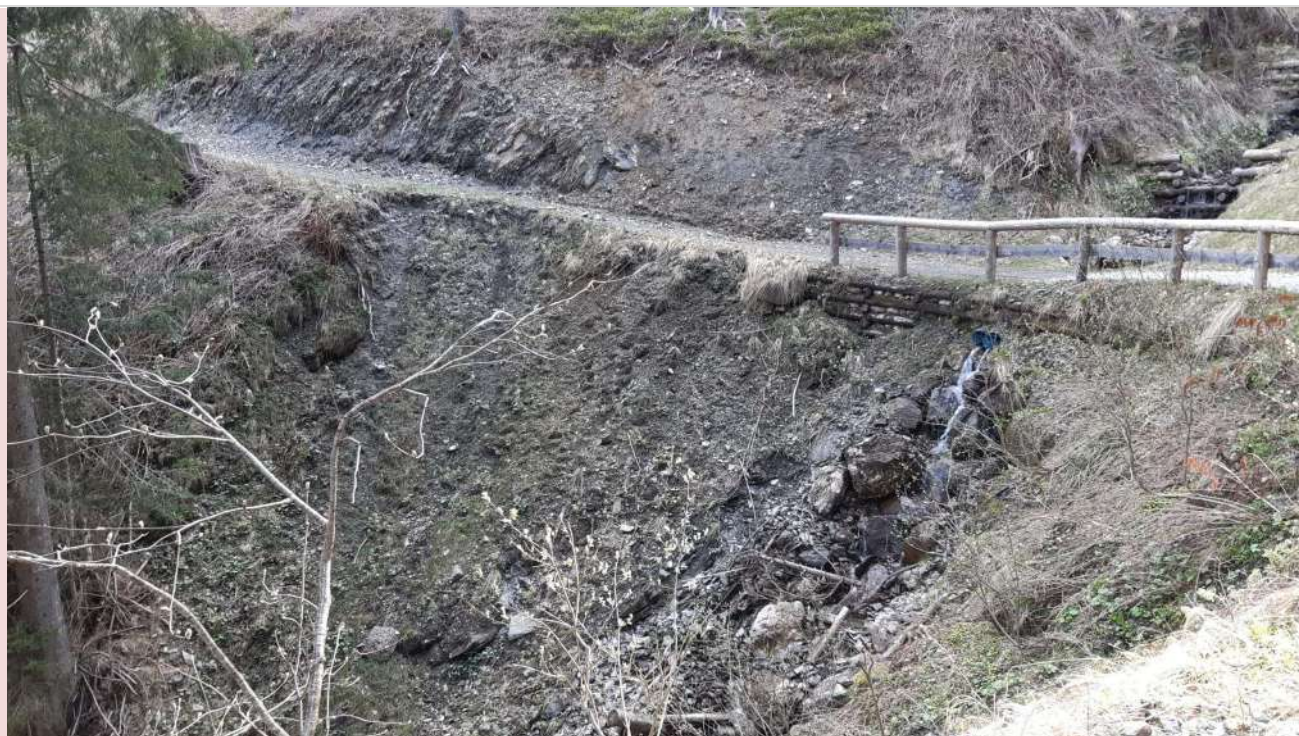
L'area dei lavori con i dissesti a monte e valle della viabilità
