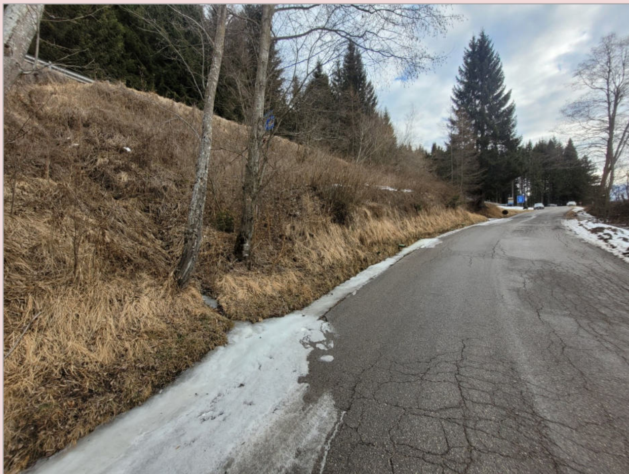
Figura 2: Foto strada comunale con evidenti segni di ammaloramento della pavimentazione
